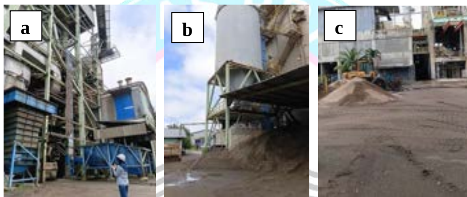
Gambar 5. (a) Ash Handling (b) Tempat Penampungan Pasir (c) Loader
