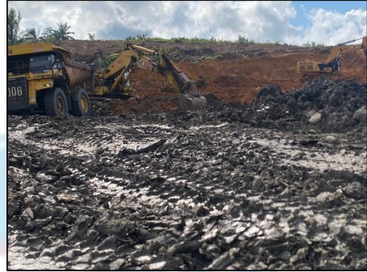
Gambar D. 2 Lantai Kerja Tidak Stabil
